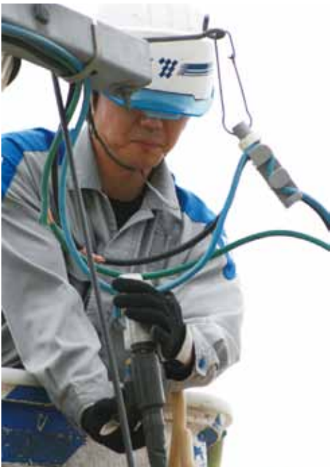
電力復旧訓練
