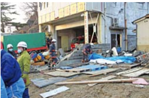
石巻広域消防本部港分署の状況
